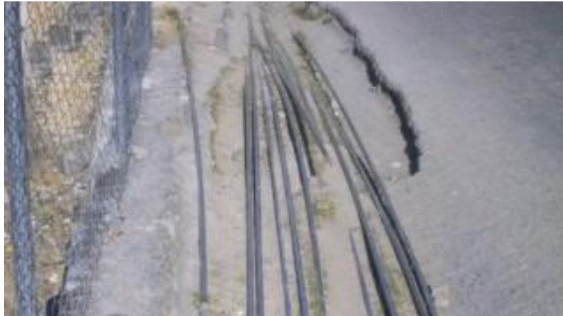
Red de agua potable expuesta
